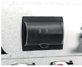
Quadro elettrico Electric panel
