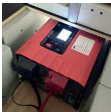
INVERTER E BATTERIA AUSILIARIA INVERTER AND AUXILIARY BATTERY
